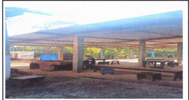
Foto 4: Cambio de pila por deterioro.
